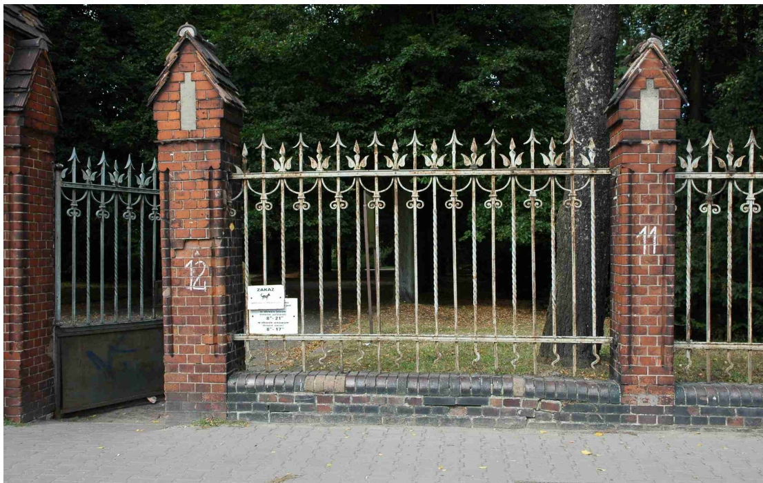
Fot.12 Przęsło 12 Rozsadzony cokół przez wstawki cementowe, wyraźna nierówność muru
