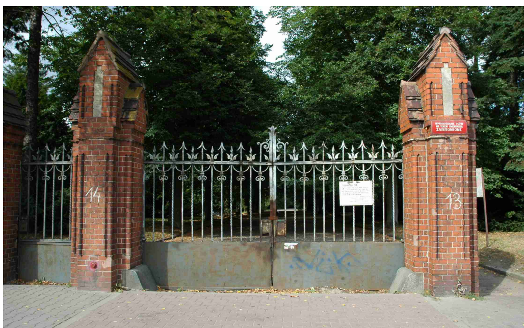
Fot.14 Przesło 14 Brama Główna Dolne metalowe płyty bramy do wymiany – silna korozja metalu
