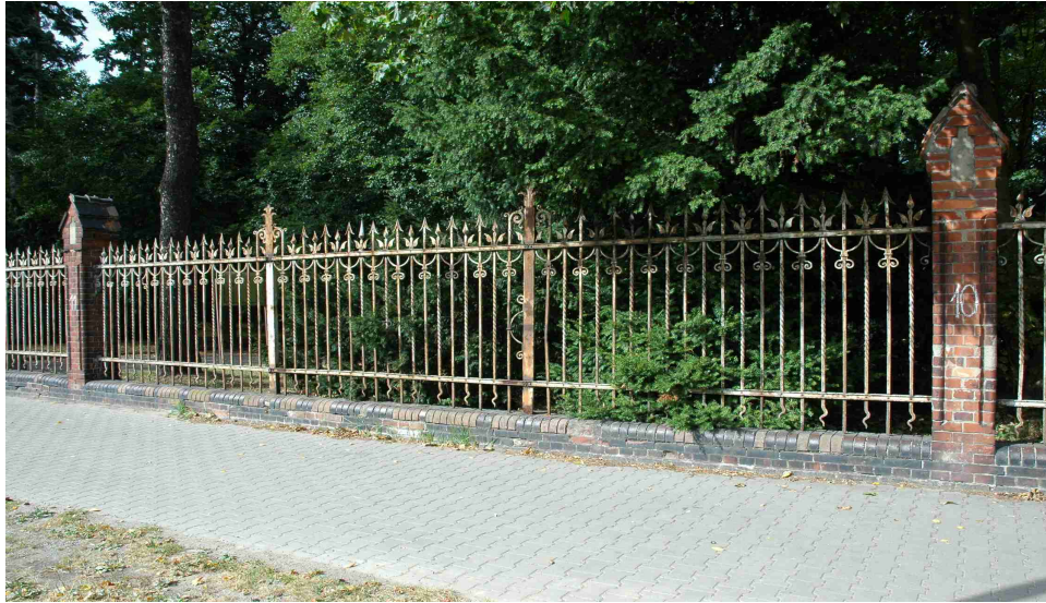
Fot.11 Przęsło 11 Wstawki cementowe “porozsadzały część cokołową ogrodzenia, widoczny w wielu miejscach brak spoin
