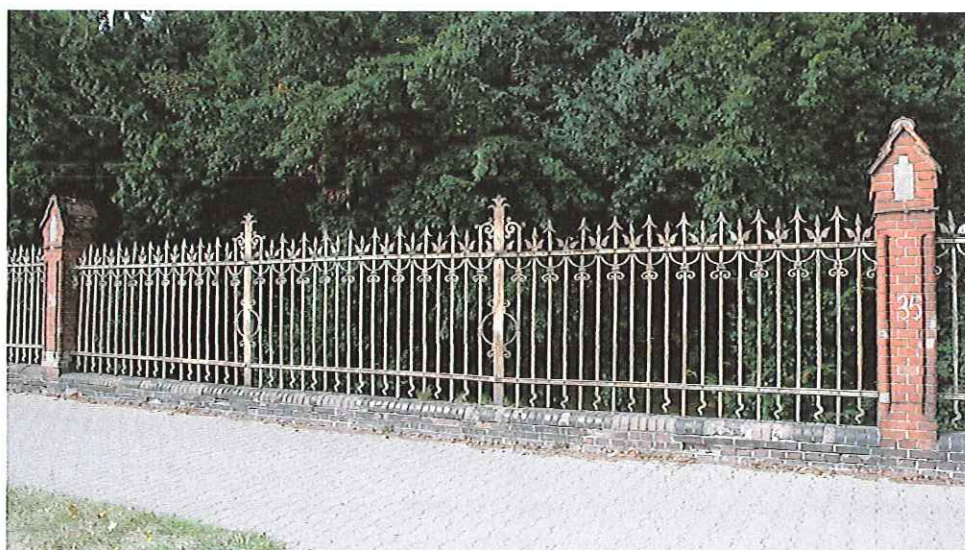
Fot.36 Przęsło 36 – widoczne ubytki w ceglach cokołu
