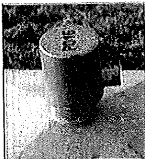
Widok głowicy zabezpieczającej piezometr z elementem ochronnym.
