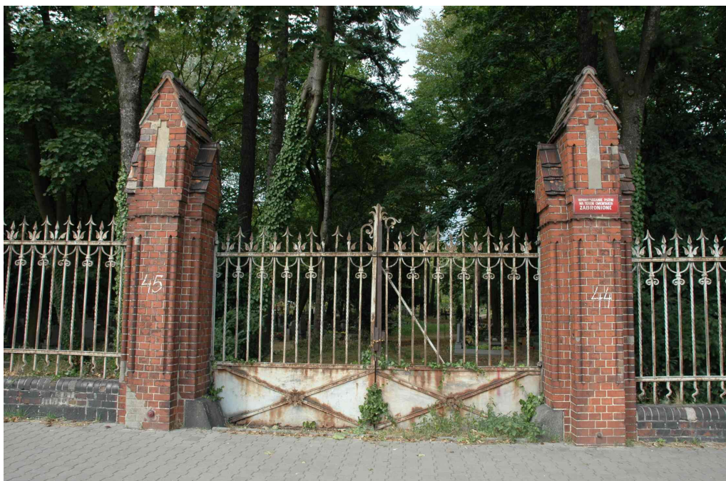
Fot.45 Przęsło 45 Brama Cmentarza – płyty metalowe bramy do wymiany, elementy ozdobne do konserwacji
