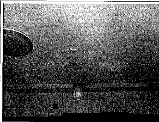
Fot. 11. Ogólny widok sufitu stropu pod chodnikiem ze śladami po przeciekach przez płytę stropową w części szaletu miejskiego przeznaczonego dla mężczyzn
