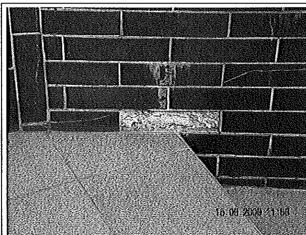
Fot. 19. Ogólny widok ściany oporowej i części ściany zabezpieczającej przy schodach do szaletu miejskiego przeznaczonego dla kobiet z widocznymi uszkodzeniami spowodowanymi działaniem niskich temperatur na skutek niewłaściwie odprowadzanych wód atmosferycznych
