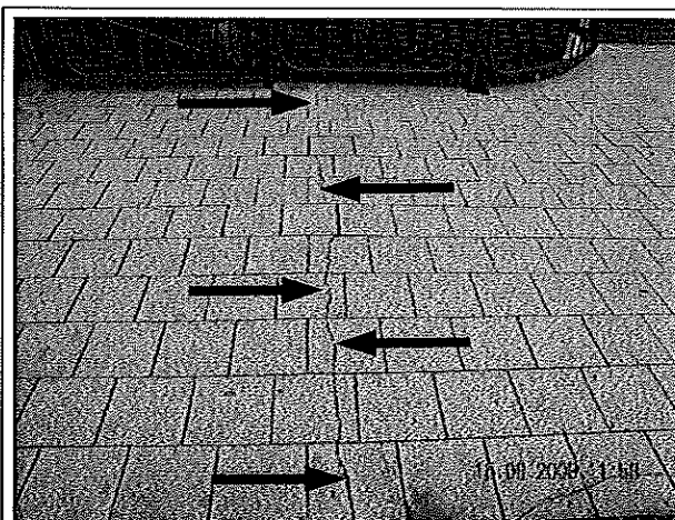
Fot. 7. Widok przykładowego pęknięcia opisanego jako P2 na płytkach chodnikowych oznaczonego strzałką czarną na stropem podziemnego szaletu miejskiego
