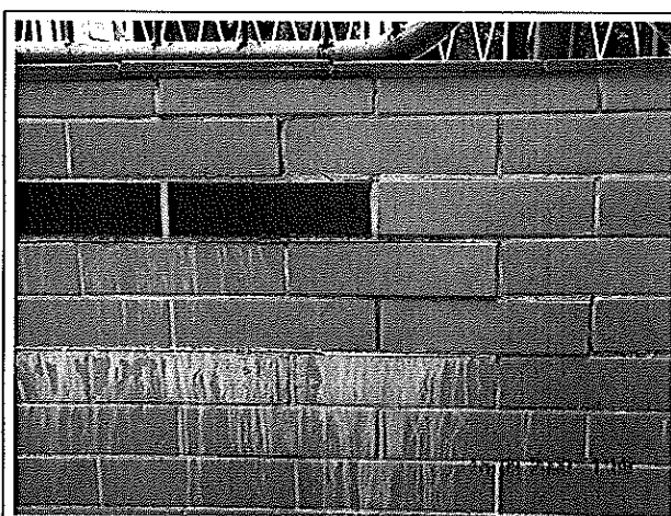
Fot. 17. Ogólny widok ściany oporowej i części ściany zabezpieczającej przy schodach do szaletu miejskiego przeznaczonego dla mężczyzn z widocznymi uszkodzeniami spowodowanymi działaniem niskich temperatur i nieprawidłowo odprowadzających wód atmosferycznych
