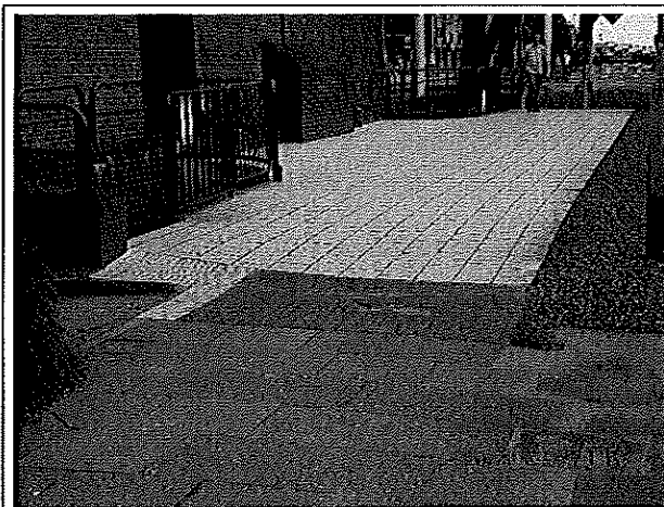
Fot. 6. Ogólny widok chodnika ze szlifowanych płytek lastrykowych znajdującego się bezpośrednio nad uszkodzonym stropem szaletu miejskiego przy Bramie Portowej
