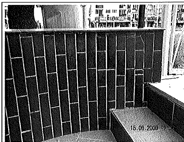
Fot. 15. Widok części nadziemnej ściany zabezpieczającej przy schodach do szaletu miejskiego przeznaczonego dla mężczyzn z widocznymi uszkodzeniami spowodowanymi działaniem niskich temperatur i nieprawidłowo odprowadzających wód atmosferycznych
