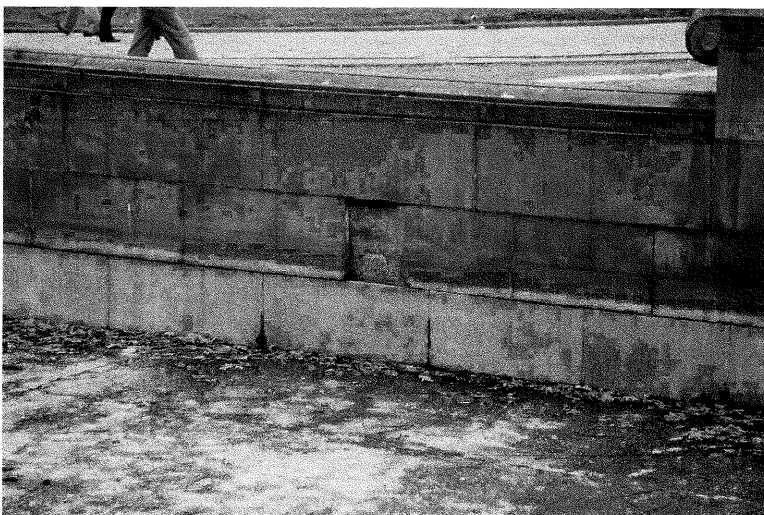
Fot.14 Silnie uszkodzony kamień misy dolnej
