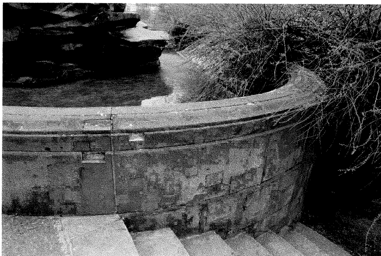
Fot.2 Widoczne stare fleki istniejące oraz ubytki po flekach.
