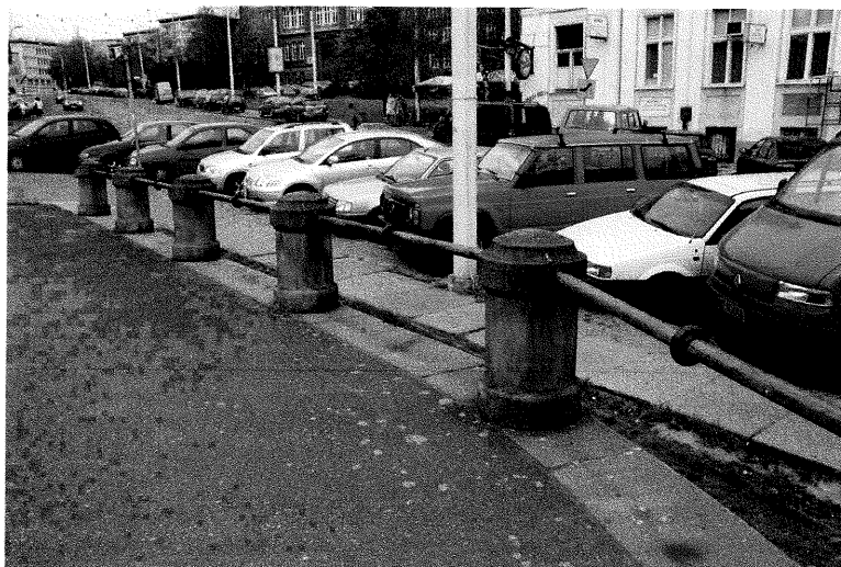
Fot.7 Słupki granitowe ograniczające plac przed fontanną – przebarwione, z nalotami korozji
