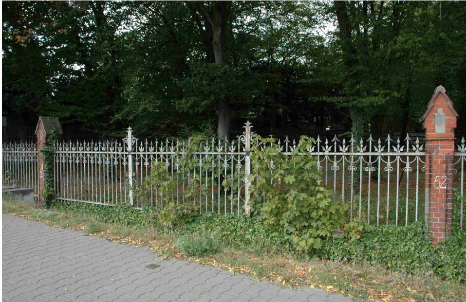
Fot.53 Przęsło 53 – część cokołowa zasypana ziemią
